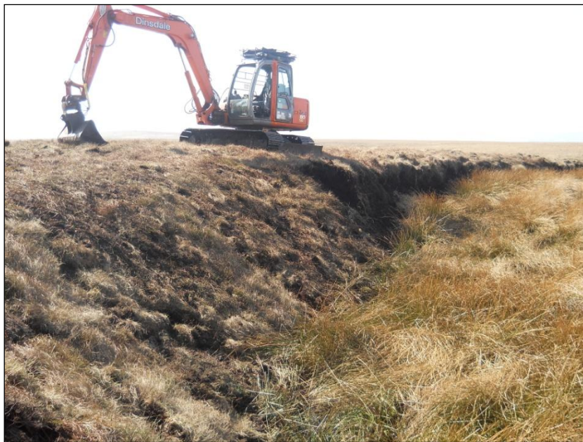
Fig.3 Drip edge re-profiling
